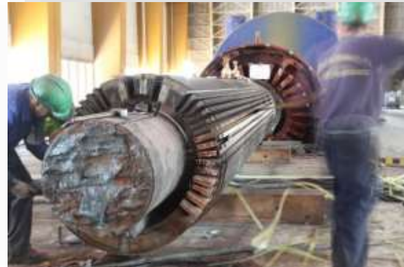
ROTOR DE GENERADOR
