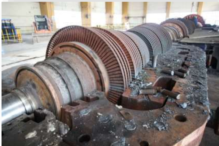
TURBINA DE ALTA, MEDIA Y BAJA PRESIÓN
